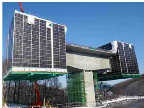
写真-1 移動作業車の養生設備
