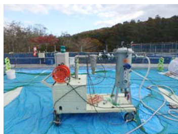
写真-6 真空ポンプ
