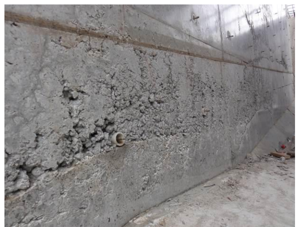
図4 豆板の発生状況(外ウェブ)
