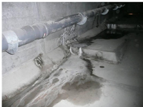
図-1 下床版定着突起からの漏水
