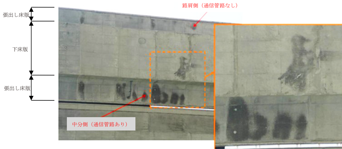
図-3 漏水が発生した橋梁の下面の外観
