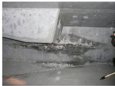
図-2 ウェブ水平打継目からの漏水
