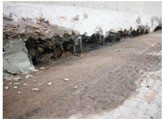
図-1-2 地覆下面の空洞の例
