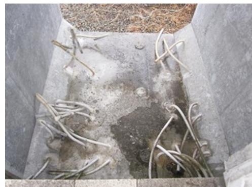
(b) 補修なし (漏水あり)
