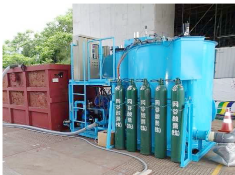
写真-5 濁水処理装置
