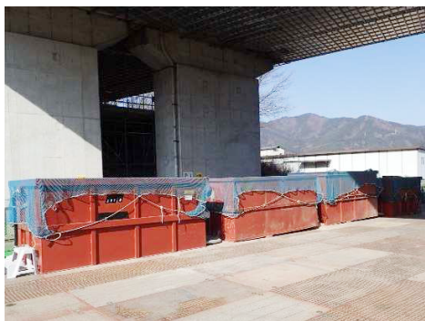
写真-4 給水水槽
