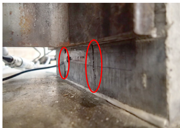
写真-5 間詰め部のひび割れ (載荷終了後)
