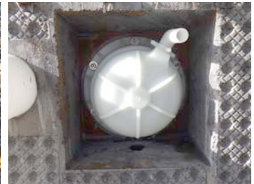
写真-4 樹脂製グラウトキャップ
