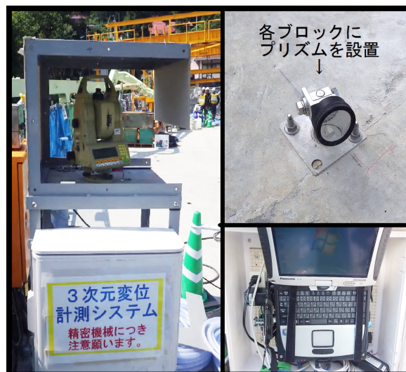
写真-1 3D 変位自動計測システム
