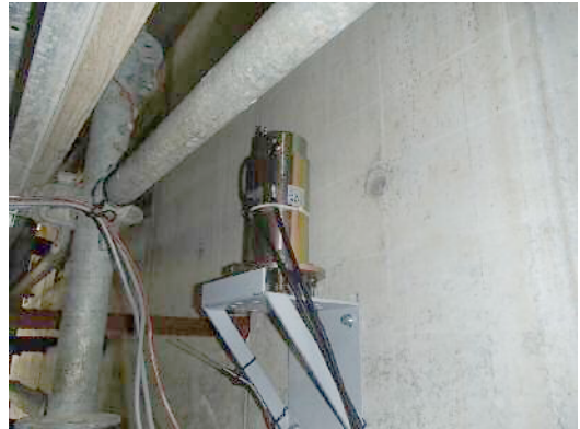
写真-2 傾斜計設置状況
