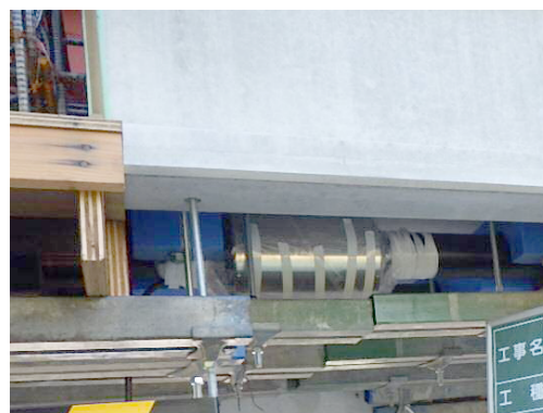
写真-1 EMセンサ設置状況
