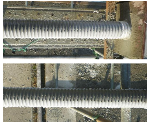
図-11 シース内の充填性 (上：A区間，下：B区間)
