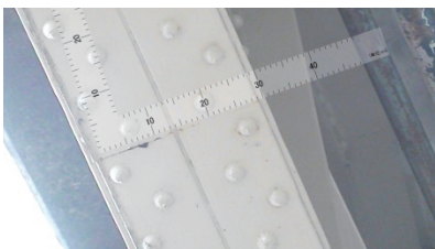
a) 塗膜の割れ長さを計測
