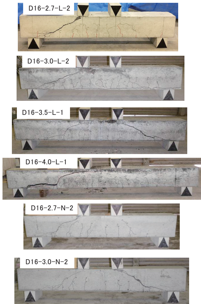
図-2 RC梁の破壊状況
