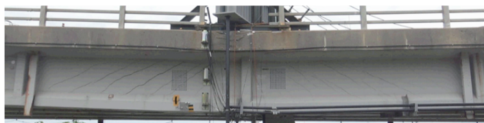
写真-4 載荷点付近の破壊性状
