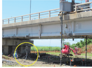
写真-6 ロボットカメラ 設置状況
