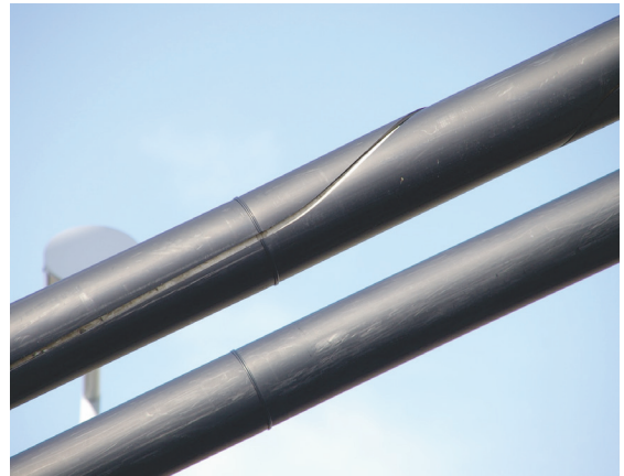
写真－1 斜材保護管の損傷例
