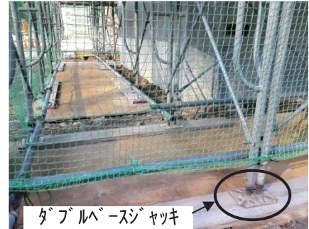
写真-2 高橋脚足場の基礎状況 (ダブルベースジャッキ、敷き鉄板)
