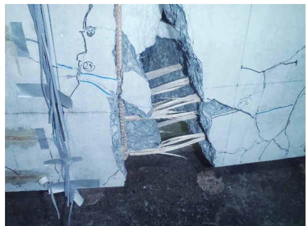
写真-5 アラミドFRP緊張材破断状況
