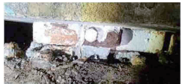
写真-1 ゲルバー部支承損傷状況
