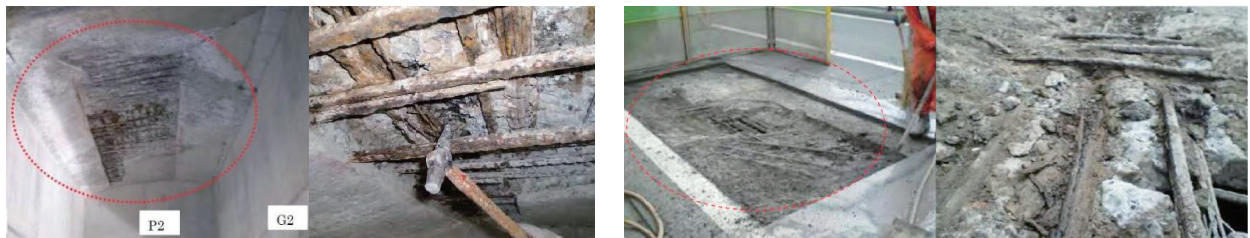
写真-1 床版下面の変状 (近接目視)
