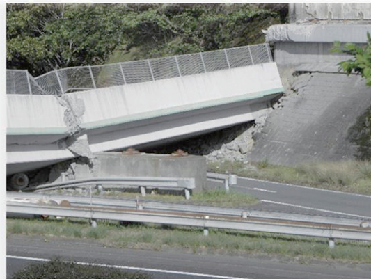
写真-1 A1 橋台側桁の落橋状況
