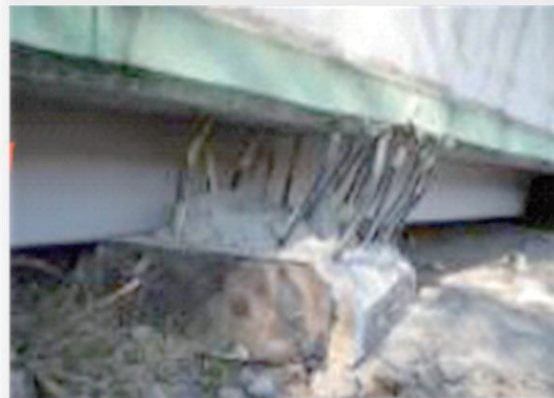
写真-2 変位制限装置の損傷
