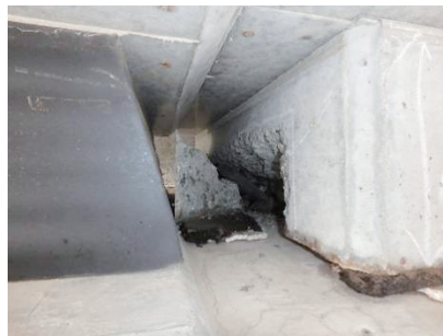
写真-4 打下し部の破損
