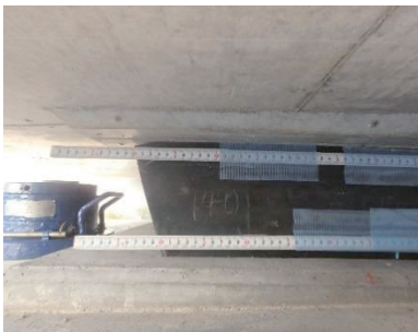
写真-3 支承の変形
