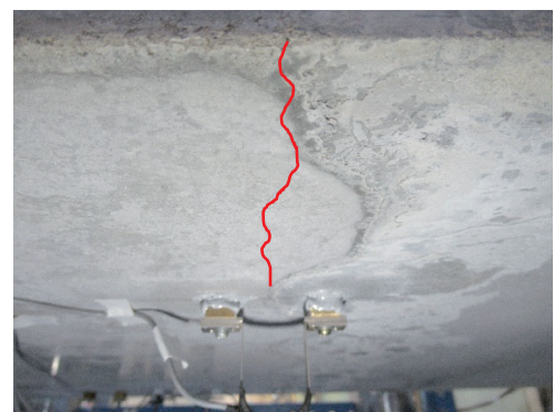
写真-5 π形変位計(SE)付近のひび割れ発生状況
