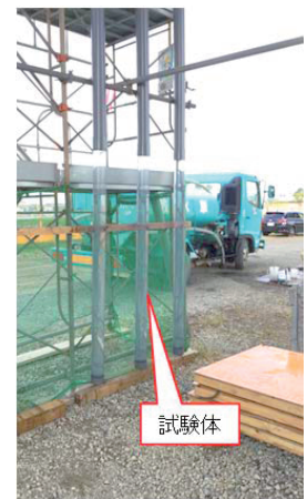
写真-3 充填試験設備
