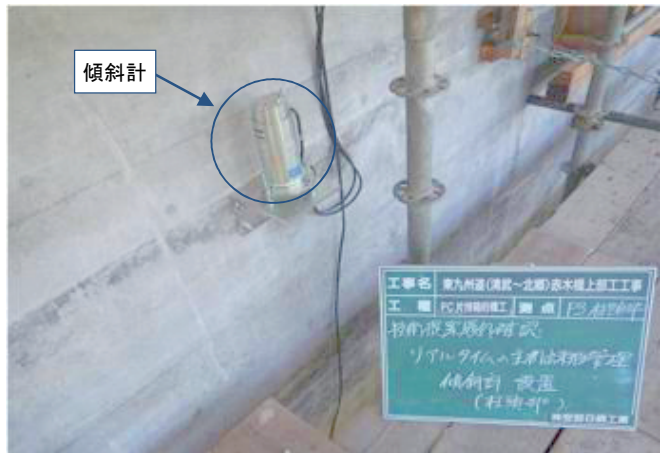
写真-2 傾斜計設置状況
