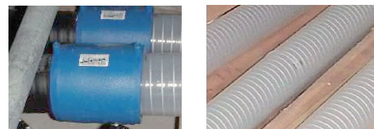
写真-4 各接続部
