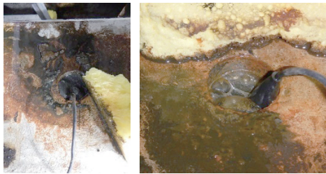
写真-4 腐食生成物の確認
