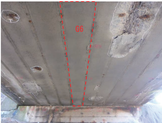
写真-2 劣化状況
