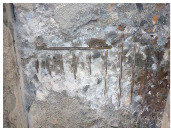
写真-3 PC 鋼線の腐食状況 (G6 桁金沢側)
