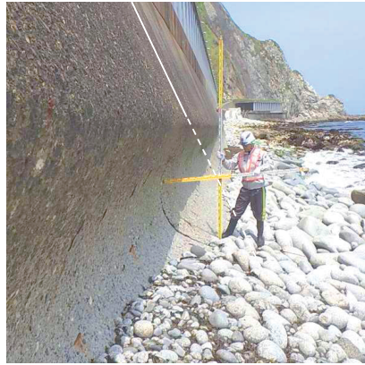
図-10 海岸擁壁の浸食状況
