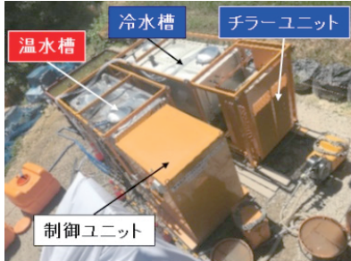
写真-4 システム全体写真
