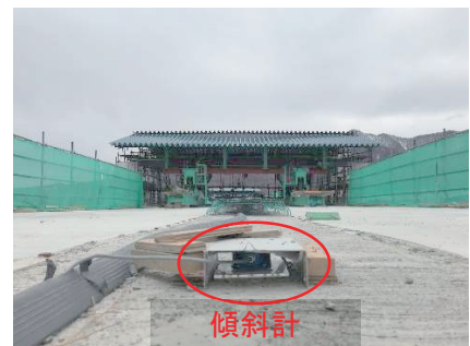
写真-4 橋面傾斜計
