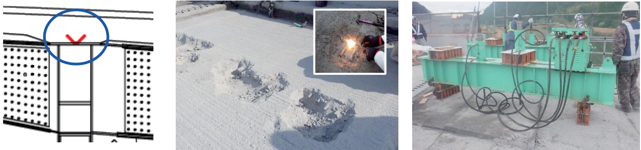
図-5 スラブアンカー 写真-4 スラブアンカー切断状況 写真-5 油圧ジャッキによる剥離
