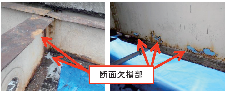
写真-10 P2 付近側縦桁腐食状況
