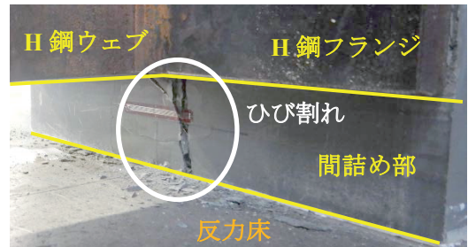
写真-3 間詰め部の割裂状況
