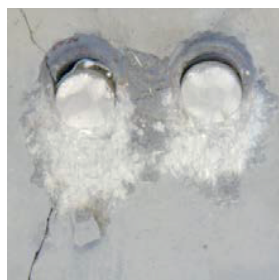
写真-2 スタッド破断面
