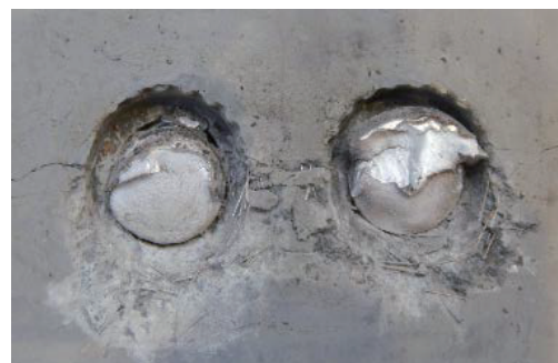
写真-5 スタッドの破断面 (試験体 F-1)
