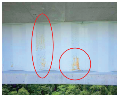
写真-2 腐食錆発生状況 (丸印内)
