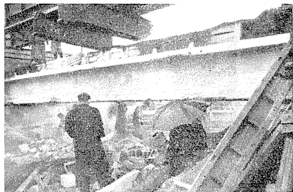
写真-1 B 桁の被害状況
