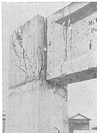
写真-4 柱頭部最終破壊状況 (柱頭部フープは PC バリを貫通していない)
