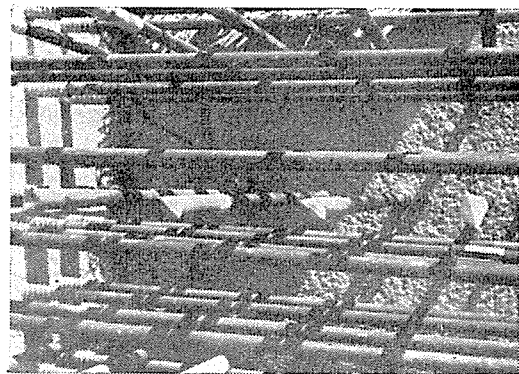
写真-2 隅角部のはつり面
