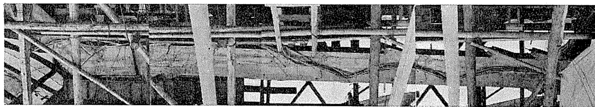
写真—3 ひびわれ発生状況
