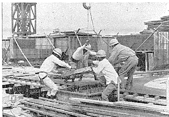
写真-5 タワークレーンによるプレキャストコンクリート版のすえ付け
