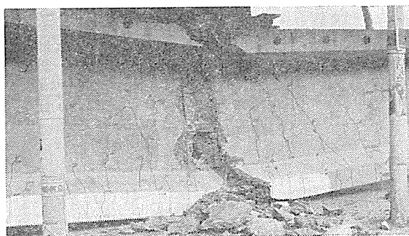
写真-3 破壊の状況
