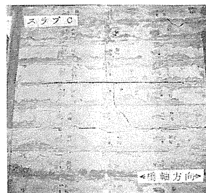
写真-5 スラブCの下縁側より みたひびわれ状況
