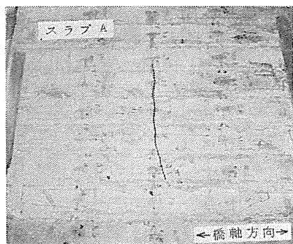
写真-3 スラブAの下縁側より みたひびわれ状況
