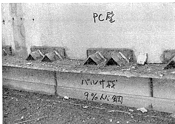
(Distri Gas Co. 143 000 kJ LNG 地下タンク)
