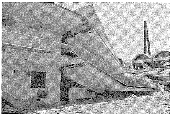
写真-10 崩壊した Divina Postoral School
