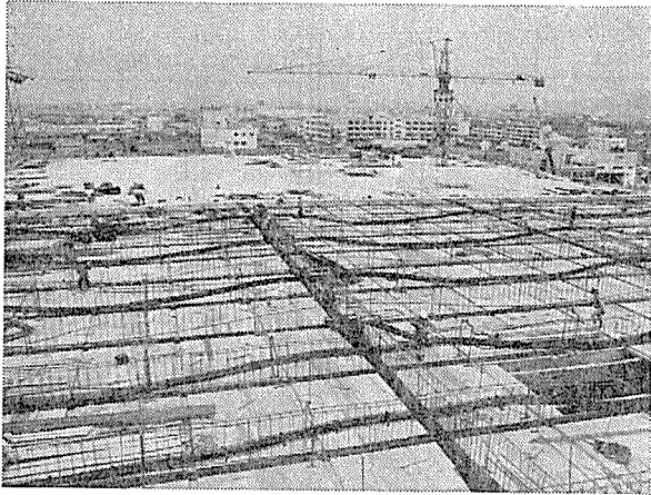
写真—5 施工中の全景。向側はコンクリート打設済、手前は型わく先行によるケーブル配線工事中
