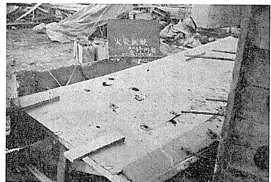
写真-7 側型枠内面の被災状況
