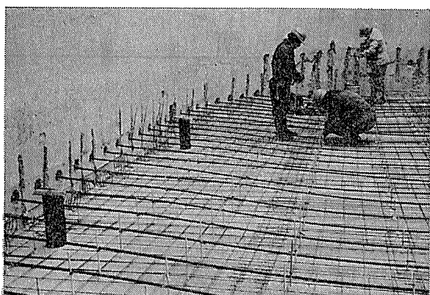
写真-2 ケーブル配置
