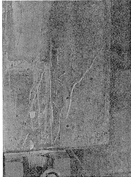
写真-1 桁端付近のコンクリートのひびわれ
