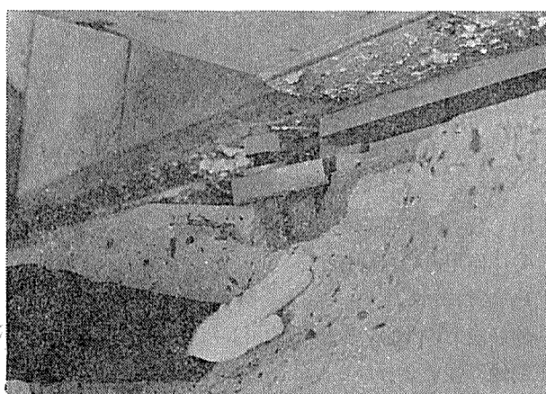
写真-4 シュー座前面のはく落
