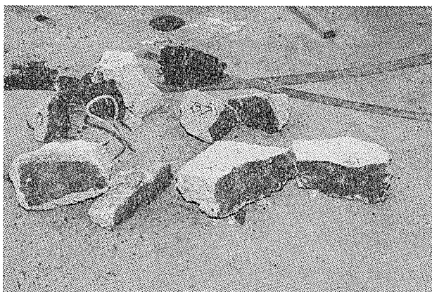
写真-16 コンクリート中性化（解体中の破片による）
