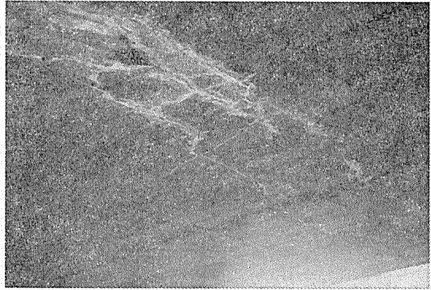
写真二 PC 箱桁下フランジのひびわれ
