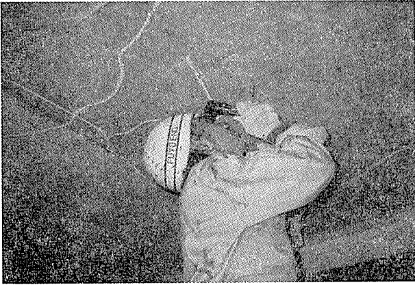
写真一 床版のひびわれ詳細点検
