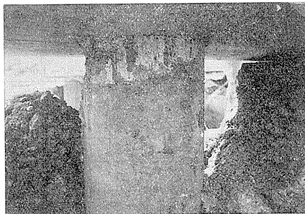
写真—5 供試体 No. 2, A 杭の破壊状態
