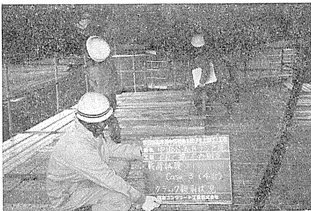
写真-2 クラック観測状況
