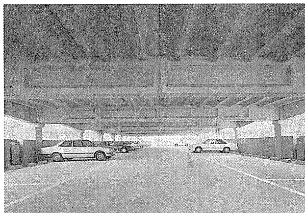
写真—4 若葉台 1-8 棟前自走式二層駐車場 (内部)
